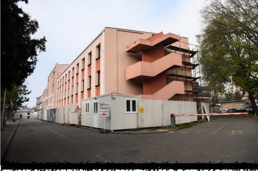
Београд, 05. децембра 2019. - Реконструкција Клинике за гинекологију и акушерство у Новом Саду је почела.
